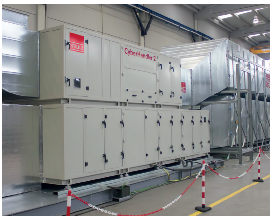
Wandinstallatie van STULZ CyberHandler-systemen
